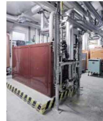
Heizungsanlage Ortsmitte Rommelsbach Erdgasniedertemperaturkessel 405 kW Erdgasniedertemperaturkessel 225 kW BHKW 50 kWel/100 kWh
