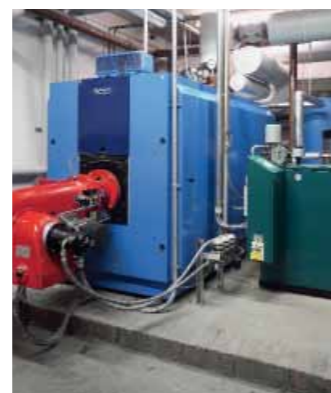
Turn- und Festhalle Sondelfingen BHKW 5,5 kWel/12 kWh
