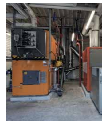
Holzhackschnittzanlage Technische Betriebsdienste Reutlingen Holzkessel 450 kW Erdgaskessel 895 kW
