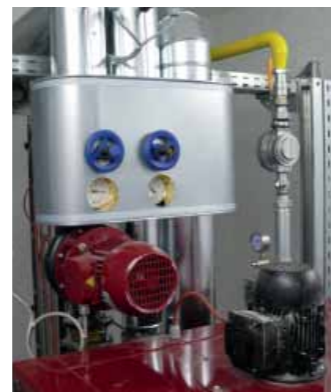
Wohnanlage Humboldtstraße Reutlingen BHKW 50 kWel/100kWh
