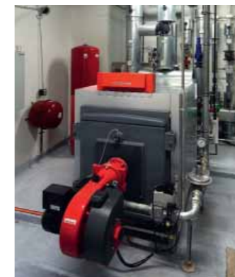
Wilhelmstraße Reutlingen Erdgasniedertemperaturkessel 510 kW
