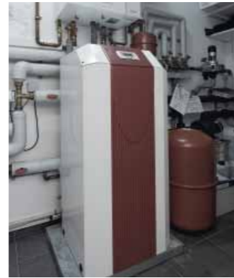
Zehntscheuer Betzingen Wärmepumpe 5,5 kWel/21 kWh Erdgastherme 60 kW
