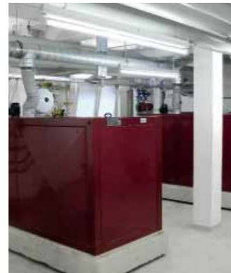
Graf-Eberhard-Schule Kirchentellinsfurt 2 BHKW je 50 kWel/100 kWh Kesselanlage 1.815 kW
