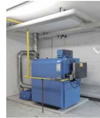
Schillerstraße Gomaringen Erdgasbrennwertkessel 115 kW
